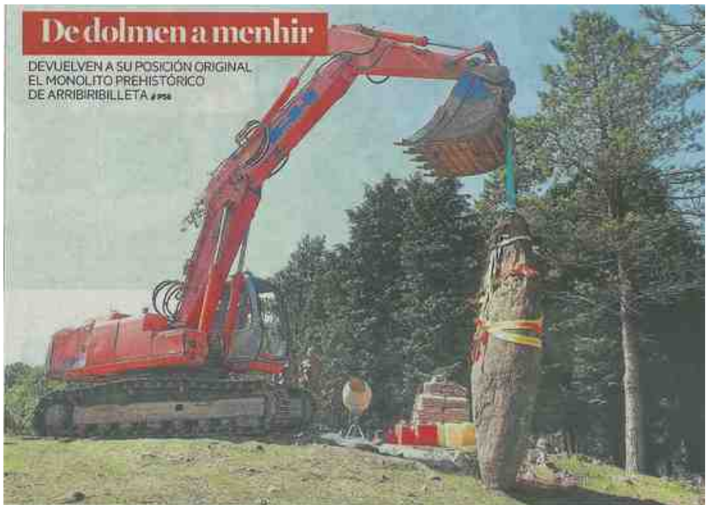
Una excavadora coloca el menhir en su posición original, ayer en la estación megalítica de Elosua-Plazentzia. Foto: Jabi León
