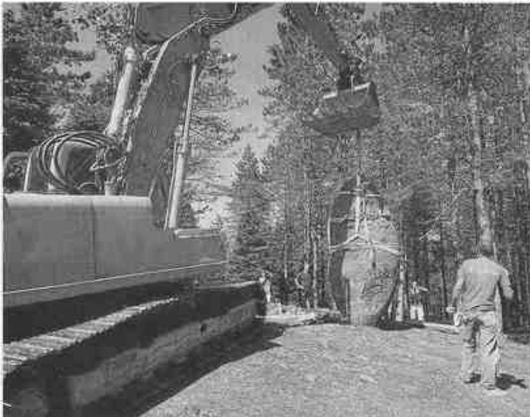
Una excavadora levanta la mole de basalto para colocarla en la posición vertical que tuvo hace 4.000 años.
